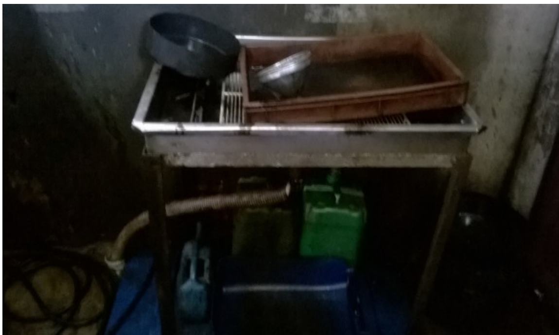
Figura 3 – Mesa e Caixa separadora de água e óleo.
